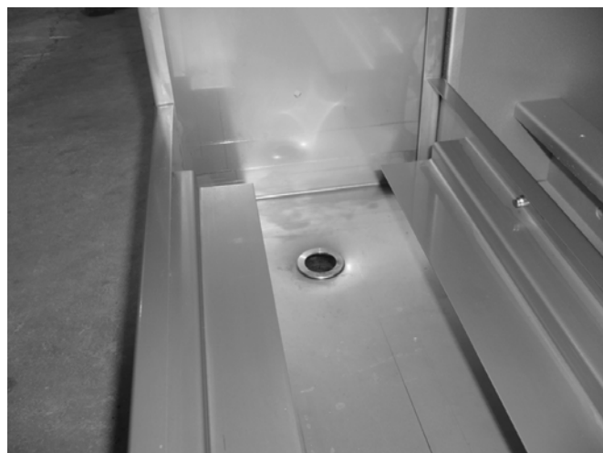
Figure 9: Système de vidange - intérieur
