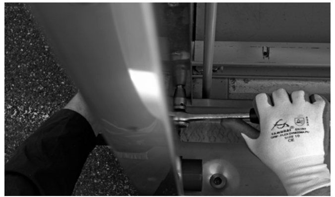
Figure 18: Montage du cadre du pré-refroidisseur sur l'aéroréfrigérant avec la visserie en acier inoxydable
