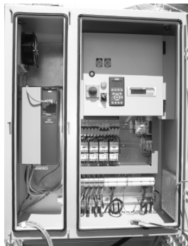
Figure 36: Coffret de commande avec variateur de fréquence
