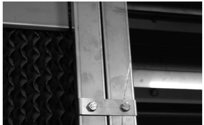
Figure 25: Cadres adjacents du pré-refroidisseur reliés par les plaques de connexion en acier inoxydable
