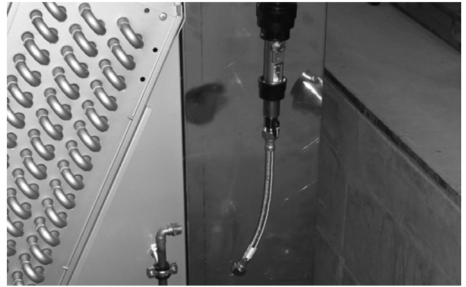
Figure 30: Connexion de l'entrée d'eau du pré-refroidisseur à la tuyauterie de distribution d'eau en cuivre pré-installée.
